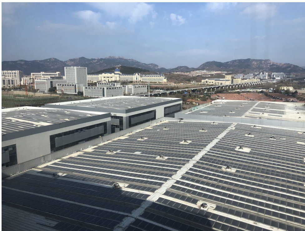
图 4 微电网 1MW 厂房屋顶光伏
