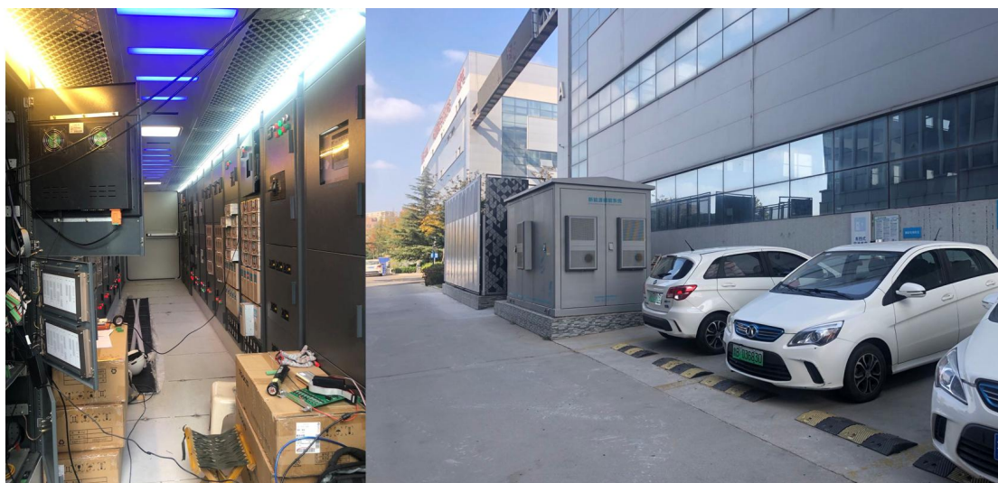
图 2 微电网 200kW 储能电站
