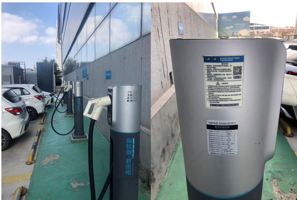
图 3 园区电动车队及智能充放电桩群（直流）
